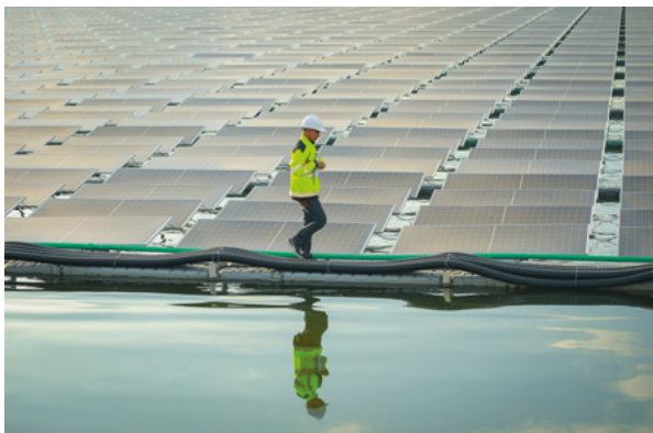
Foto: Servicemitarbeiter bei der Wartung einer schwimmenden Photovoltaikanlage (© Adobe-Stock / Natin Sapaisarn)
